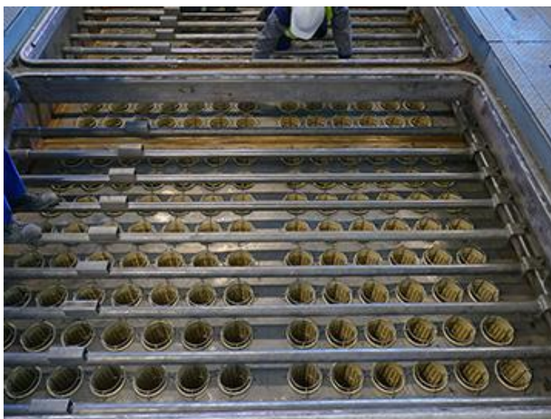
Rysunek 50. Worki na filtrach workowych w spalarni odpadów komunalnych XYZ
